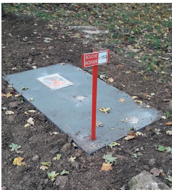
Points eau incendie.
